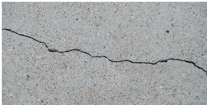
Рис. 4.6.1 Трещина в бетоне
