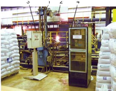
Рис. 3. Расположение узлов толщиномера МТП-10П в цехе ОАО «ЧТПЗ»
